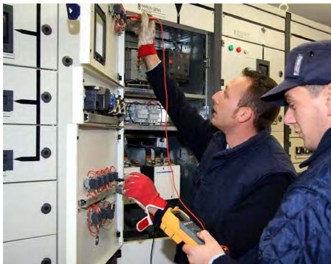
ACQUEDOTTO FANACO MADONIE OVEST CENTRALE DI SOLLEVAMENTO "LISTE"
