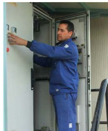
IMPIANTO DI POTABILIZZAZIONE DI GELA
